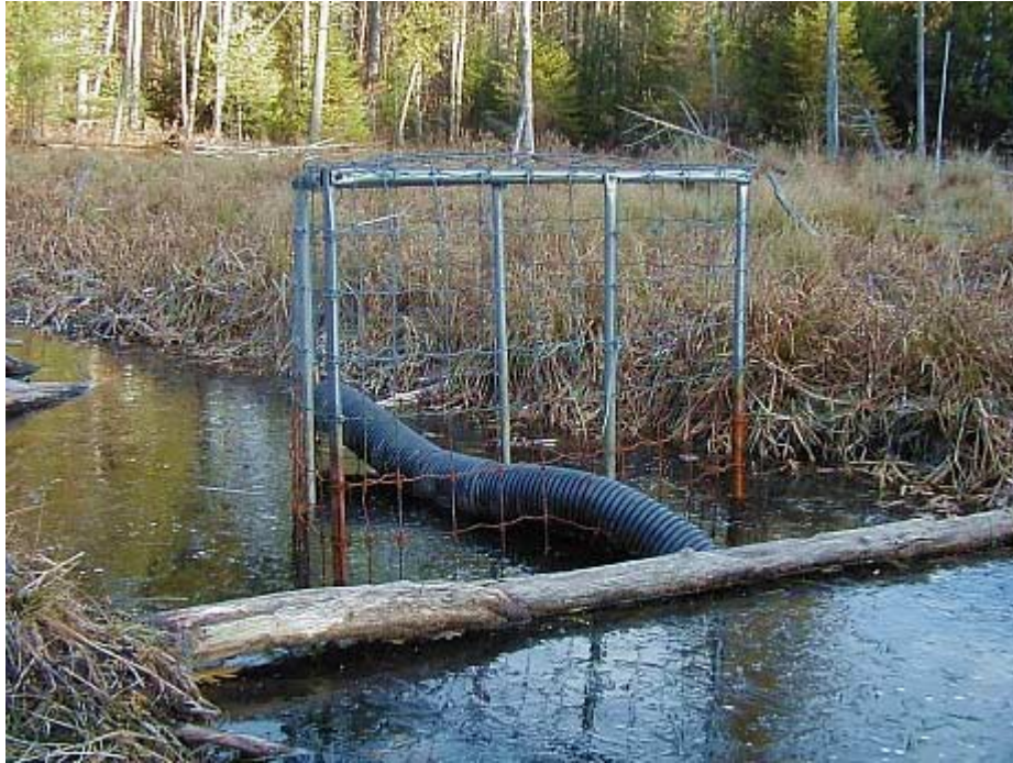
Rys. 5 Zabezpieczenie wlotu rury metalowym koszem (Gatineau Park, Kanada)
